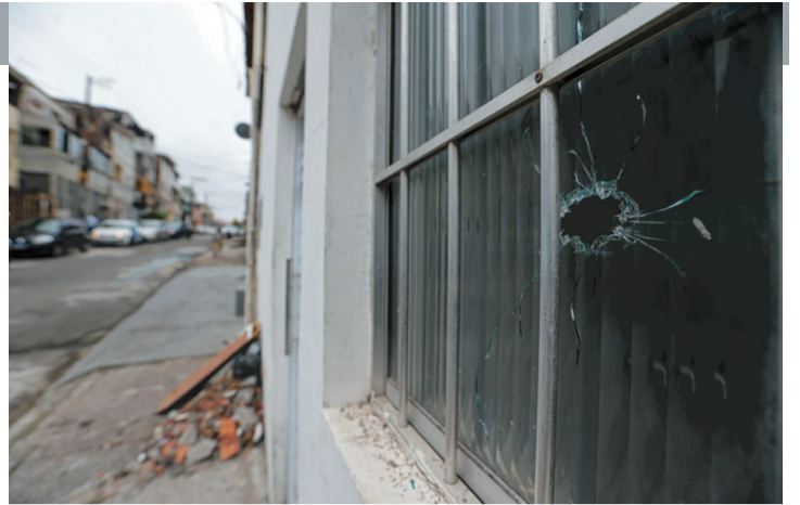
Homens armados chegaram atirando em estabelecimento do bairro
